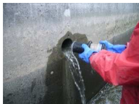
写真-22 流出状況
