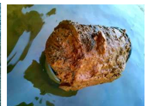
写真-20 目詰まり状況
